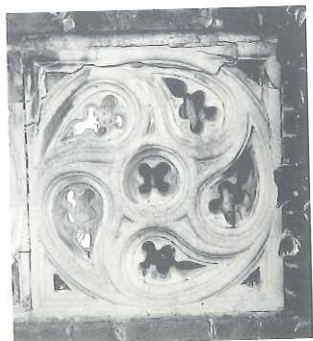
Casa Breschi. Particolare di una formella di cemento in facciata.
